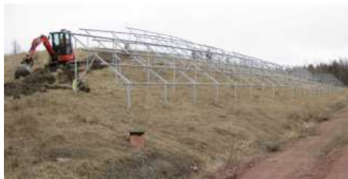
Solcellspark på gång. Överloppsel styrs ut i elnätet.
